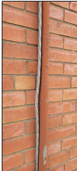
50. Wires not run in conduit
